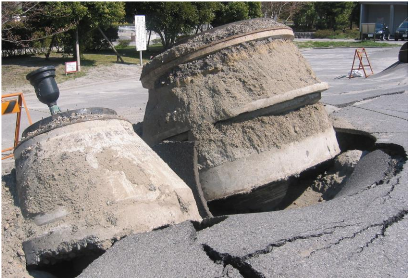
液状化現象で浮き上がったマンホール
