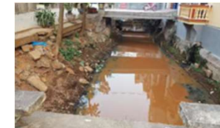
生活排水路に流出した汚泥（ベトナム）
